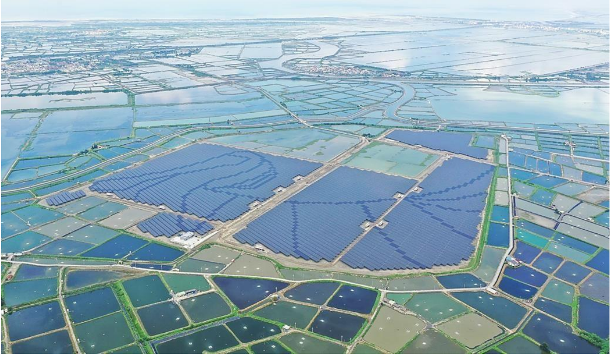
[业绩]台湾嘉义县 Vena Energy Taiwan Solar Energy 公司 70MW 太阳能光伏电站航拍照片。
