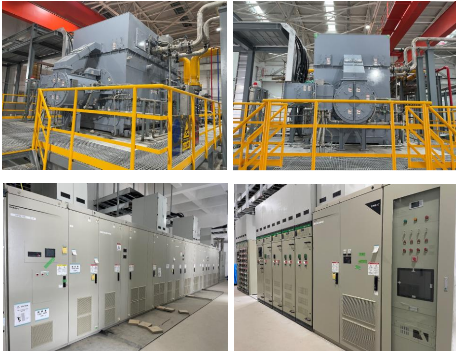
TMEiC 电机和高压变频赋能压缩机启动成功
