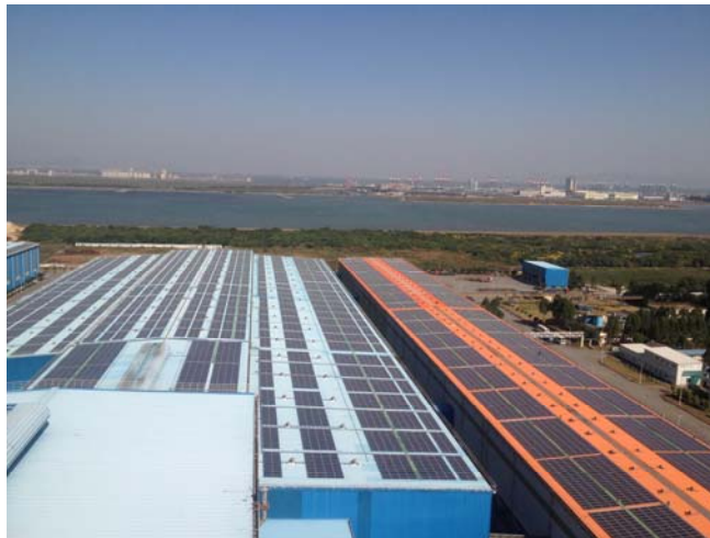
广州 JFE 光伏电站
