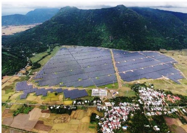
SaoMai II 光伏电站
