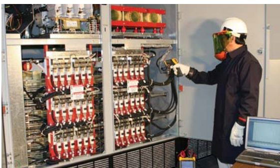
Comprobación del variador de frecuencia Dura-Bilt5i MV
